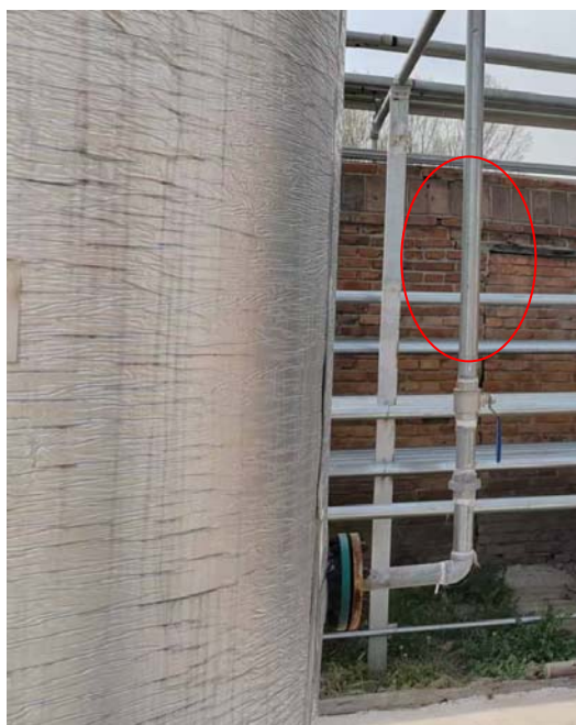
整改前管道未设置安全色、安全标识
