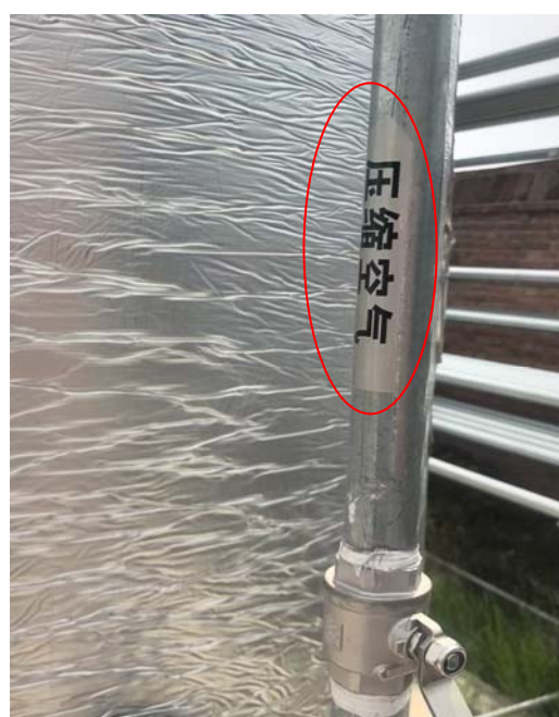
整改后管道已设置安全色、安全标识
